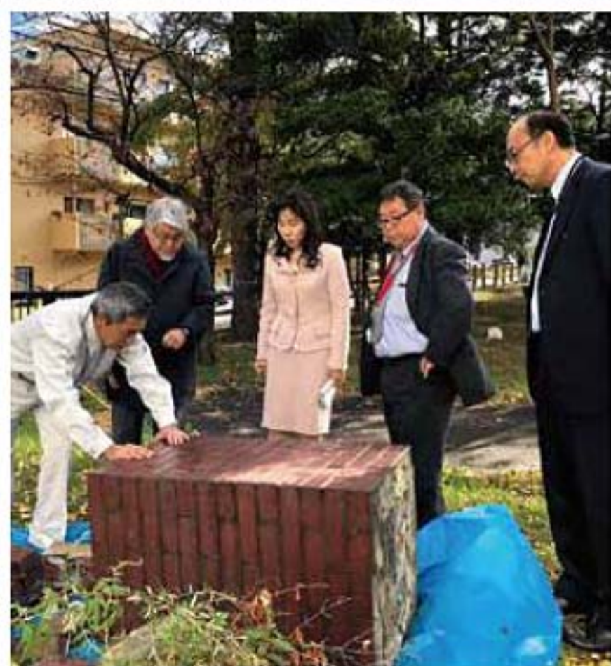
倒壊した門柱を現場にて検証
