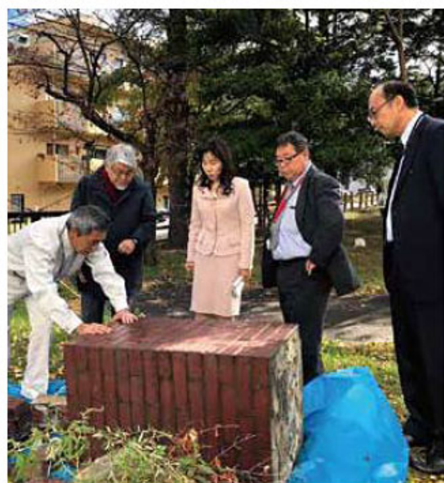
倒壊した門柱を現場にて検証
